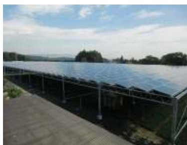
農地に設置されている太陽光発電
