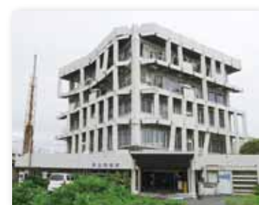
地震で被害を受けた 宇土市役所庁舎 (5/6 撮影)
