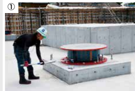
▲「積層ゴム支承」と呼ばれる装置です。地面の揺れを建物へ伝えにくくするとともに、建物の揺れを止める働きをします。
