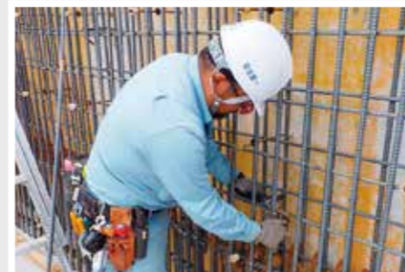
▲雷保護設備の配線をしています。落雷した場合でも庁舎内の機器などを保護します。
