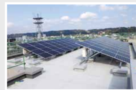
▲新庁舎棟 屋上に太陽光発電パネル(20kw)が設置されました。非常時は自家発電設備とともに電力を供給します。
