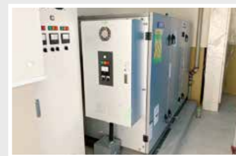
▲新庁舎棟 機械室内に空気調和機器が設置されました。この機械で各階の温度管理を行います。
