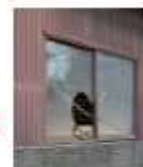
窓が割れた 管理不全空家
