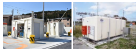
地上タンクの例 ※令和元年度の資源エネルギー庁 モデル事業(左図、長野県下伊那 郡売木村)は、先行事例として 参考にした
